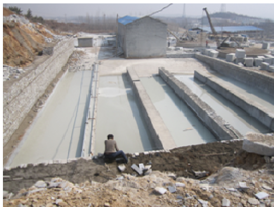
In dieser Fabrik in ShanDong wurde in eine neue Wasserrecyclinganlage investiert.
